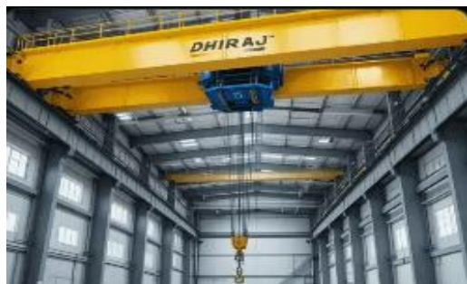
EOTクレーン
