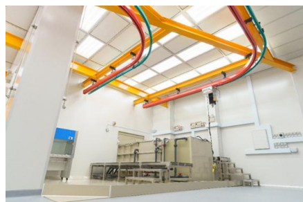
半導体及び医療機器向け クラス1Kクリーンルーム
