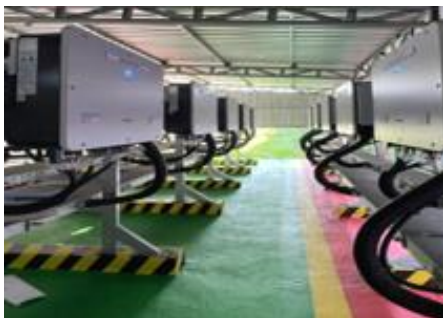
発電所内設備
