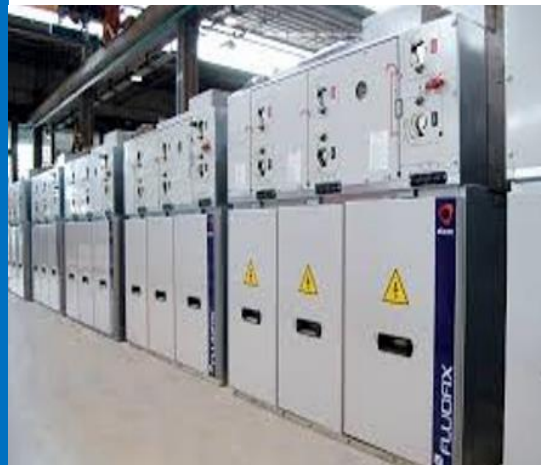
動力電源装置
