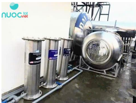
全館浄水装置
