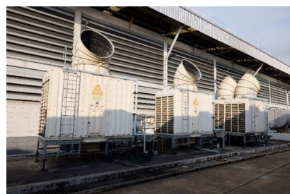
ゴム製造工場の 空調換気システム
