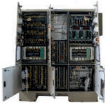
インド鉄道のシステム及び電源制御パネル
