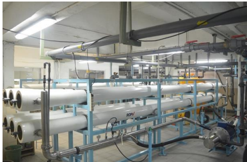
水処理関連設備機器
