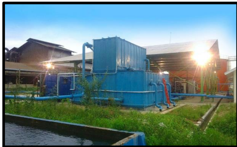
浄水設備（処理量：毎秒35L）
