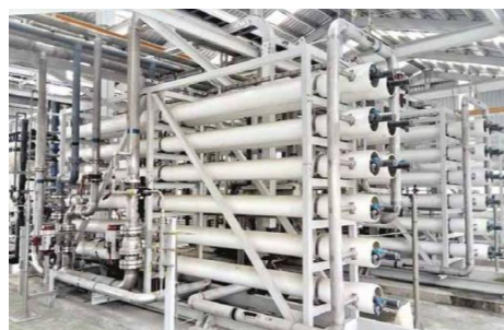
ナノろ過装・浄水置装置
