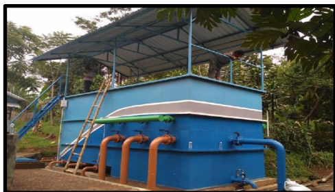
浄水設備（処理量：毎秒20L）
