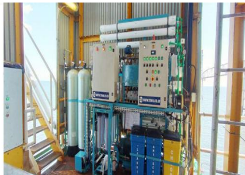
水処理関連設備機器
