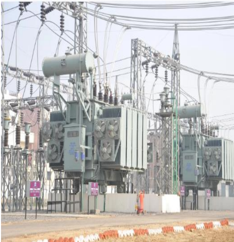
変電所、超高压変圧器
