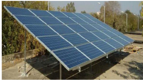
太陽光発電システム
