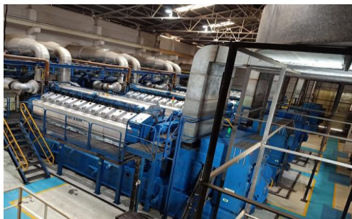
36 Mw の設置容量を持つエンジンルーム
