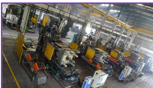
ダイカスト設備
