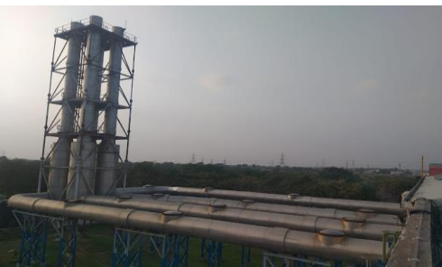
4 基のエンジンの排気システム
