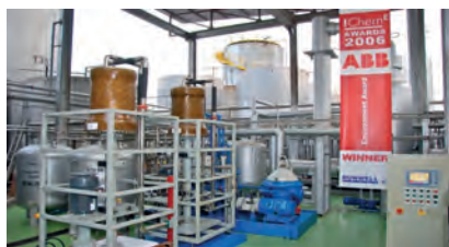
廃油リサイクルシステム
