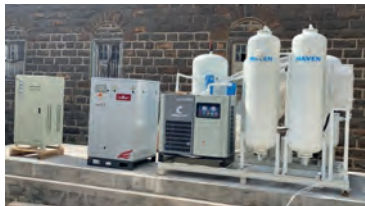
PSA式酸素ガス発生装置
