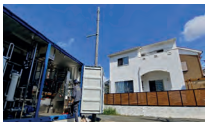
排水処理システム
