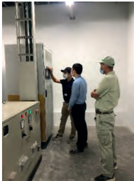
自動電圧制御装置
