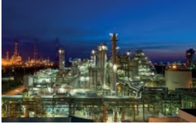
発電プラント
