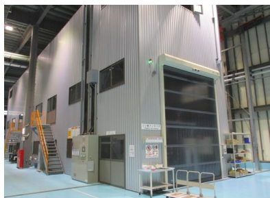
Grande cuve de traitement sous abri
