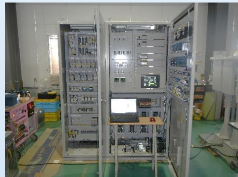
ゲート動力制御盤
