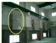
三重県 津市 (3) ポンプ場換気用消音設備
