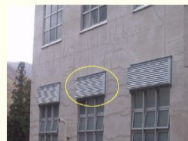
T電力株式会社 秋本発電所 欄間吸気用IKルーバー (6)
