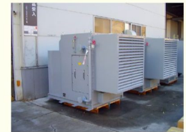
N電信電話会社(株) (3) リモートラジエーター用消音器
