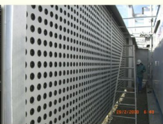
プラントエンクロージャー
