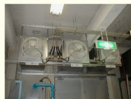
同左 浄水場 (3) 換気扇用消音器
