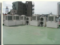
屋上室外機防音スカート
