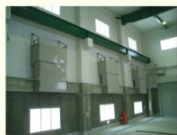
ポンプ場換気口 (消音)
