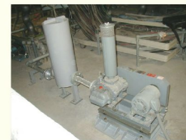
攪拌ブロワ吐出側
