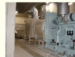
T電力株式会社 (3) EG室内消音設備
