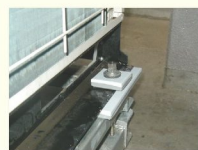
室外機 (音響遮断)
