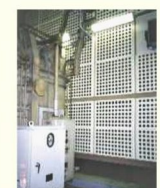
T電力株式会社 (2) トランス室内遮音パネル
