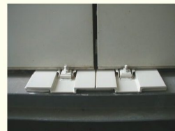
所沢市 (5) 空調室外機用音響遮断
