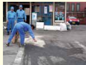
舗装面へこぼれた油の除去
