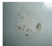
写真-2 直火を受けたコンクリート
