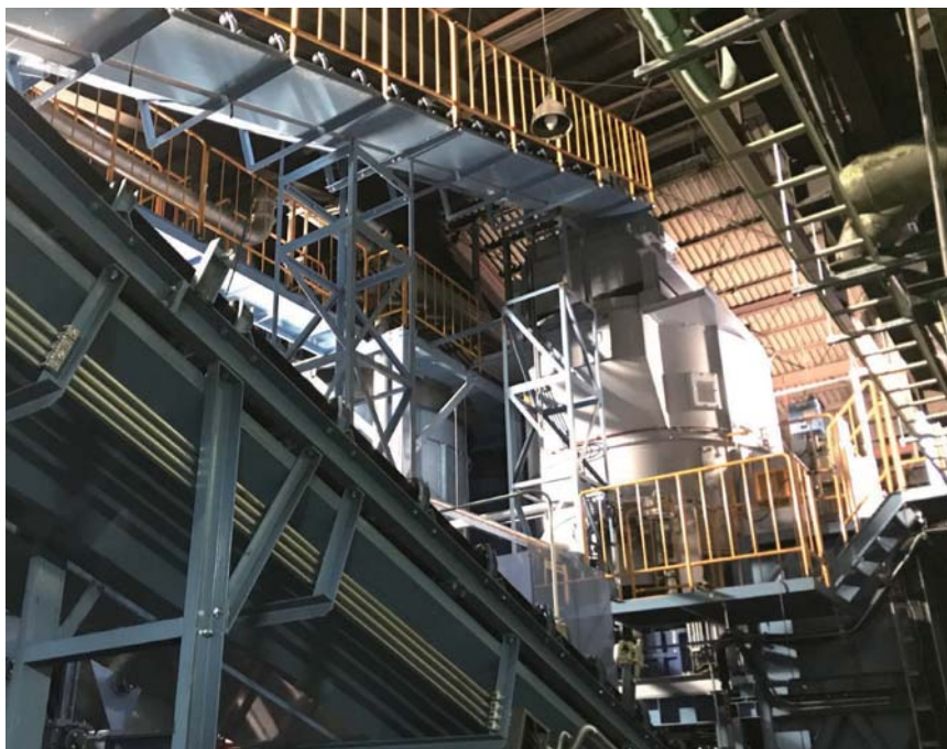
砂処理プラント
