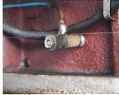
給電ブロック
