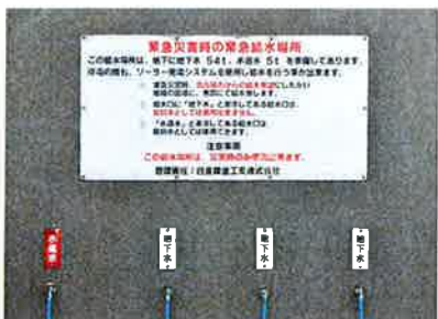
緊急時の給水設備
