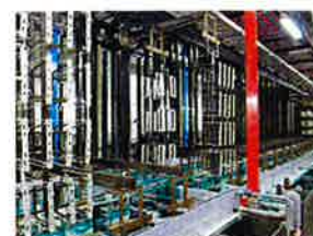
金属めっき装置（エレベーター）
