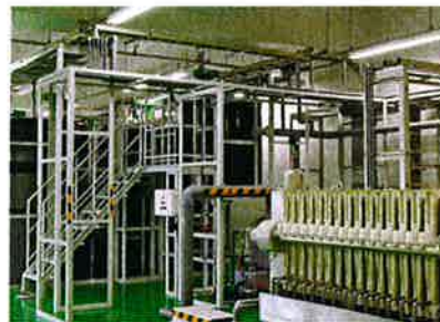
排水処理施設
