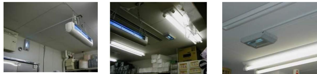
コープ神戸西宮北口店 畜産作業場・生ゴミ庫： 除菌脱臭・虫除け
