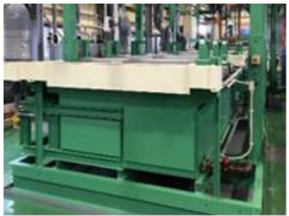
亜鉛アルミフレーク処理設備
