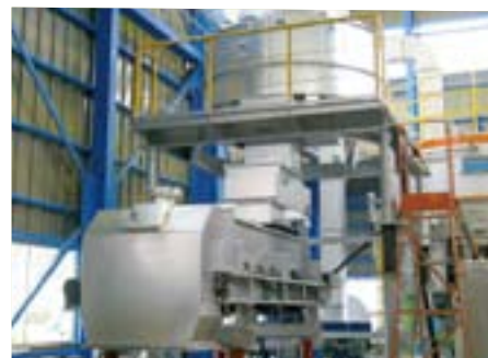
廃プラ供給システム
