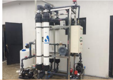
ダナンリゾートホテル向け 全館浄水(UF 膜ろ過) 1,500L/h
