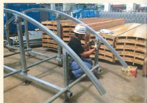
トンネルセントル
