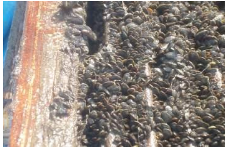
取水ロスクリン部既存付着状況
