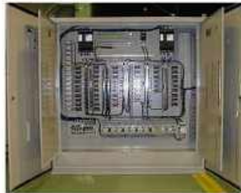
照明用分電盤 (W=2200,H=1800,D=550)
