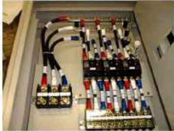
電源分岐盤 (内部配線状況)
