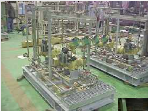
薬液注入ユニット
