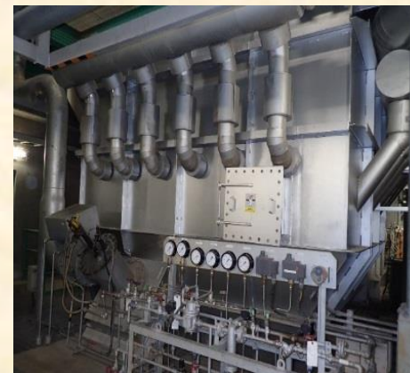
廃棄物処理場向/焼却炉
