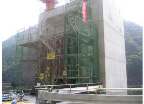
日立造船(株)【九州電力(株)】 宮崎県小丸川発電所 放水口制水門 5m×5m 2門
