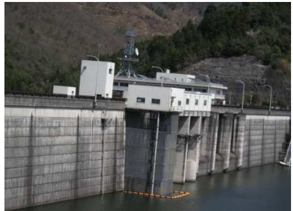
(株)クリモテクノス (国土交通省九州地方整備局) 大分県中津市 耶馬溪ダム スクリーン 2.5m×3.0m 54パネル 呑口部スクリーン φ3.3m×2.8m ゲート引掛装置、タラップ
