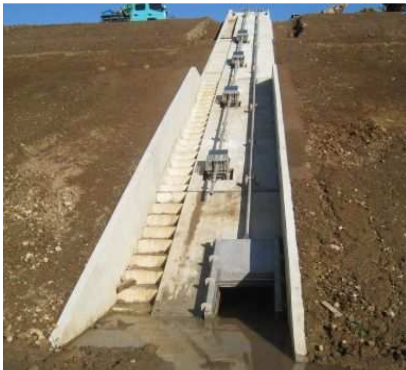
田幸建設(株) (大分県東部振興局) 大分県国東市 ため池工事 取水バルブ φ250 4台 土砂吐きゲート 1.0m×1.0m 1門
