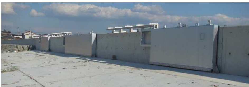
玉名地域振興局 玉名郡長洲町長洲地内 陸閘 横引ゲート(アルミ製) 3.0m × 1.4m 2門 5.0m × 1.4m 1門
